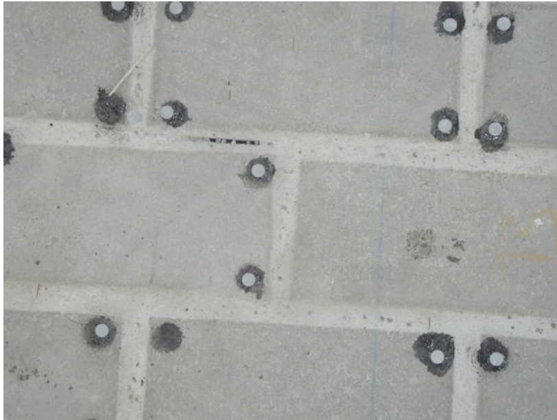
Abb. 10: Ansicht der Fugen nach Beendigung der Versuche (Pflaster auf Schottertragschicht)
